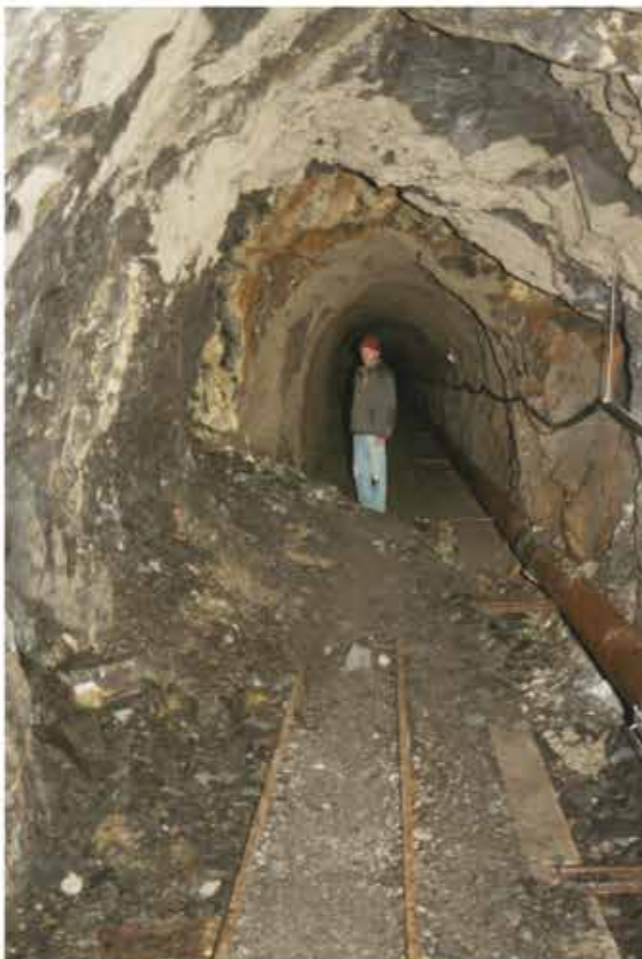
Nicht immer führt der Stollen durch soliden Fels. Die gefährdeten Abschnitte wurden bei der Sanierung gesichert, das Gleis entfernt und die stark angerostete Wasserleitung durch eine neue ersetzt. (Foto: Chronos)
