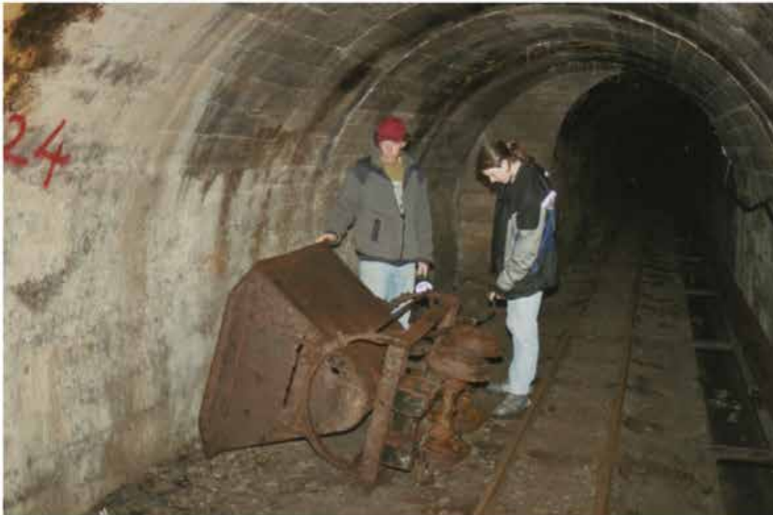
Ein Blick in den Stollen vor der Sanierung. Der verrostende Stollenhant ist wohl vor 70 Jahren zum letzten Mal beladen worden. (Foto: Chronos)
