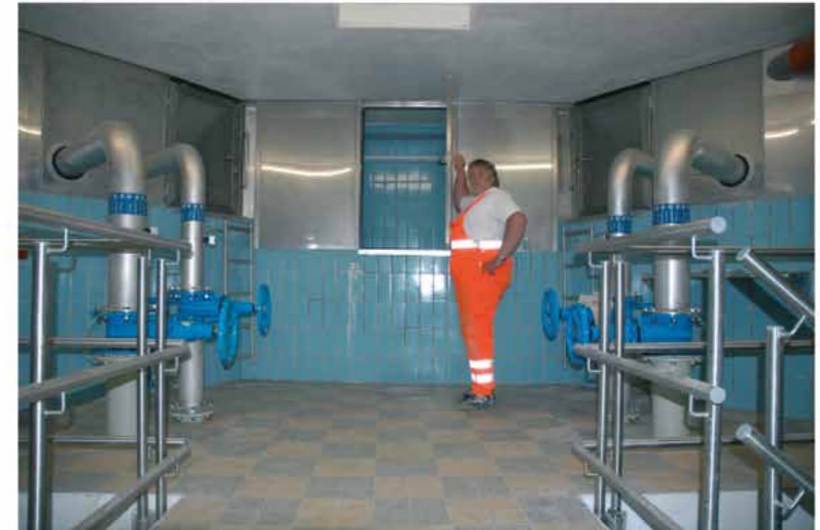
Mitte der 70-er Jahre wurden die beiden Hochbehälter am Adolf-Pichler-Weg errichtet. Jeder fasst 900 m 3 Wasser. Damit wurde erstmals eine Trennung in zwei Druckzonen möglich. (Foto: Chronos)
