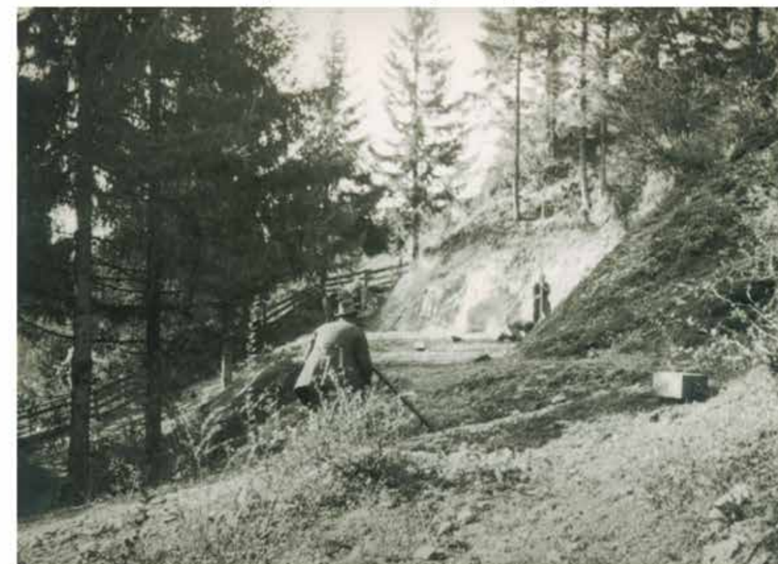
Vermessung beim Platz für die Betriebsbaracke. Neben dem Zaun im Hintergrund führt der Weg hinein ins Bangartl. (Bestand: Sammlung Hans Spötl)
