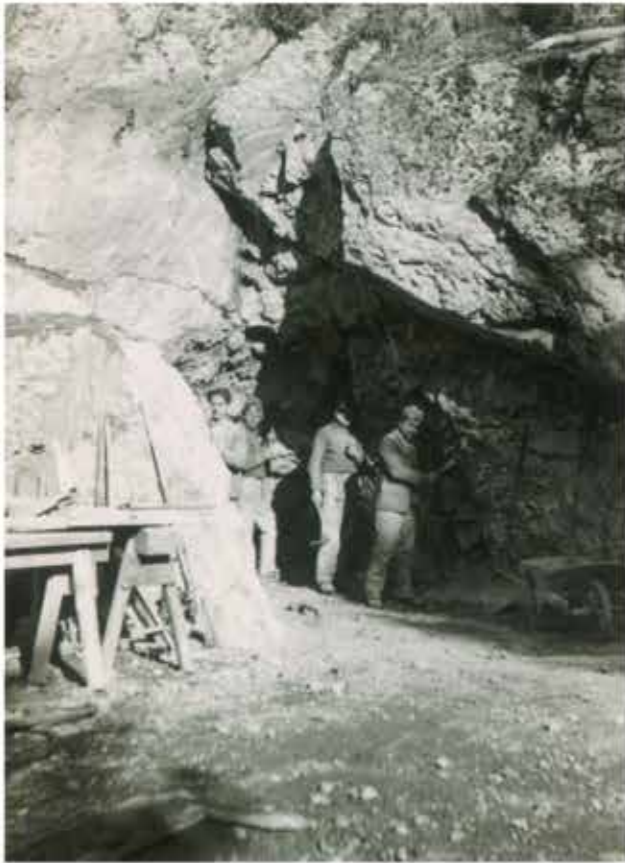
Erste Arbeiten am Stollenmundloch. Rechts Feichtner Karl und daneben eine der damals typischen italienischen „Radlruch'n“. Zu Beginn der Arbeiten musste man sich noch mit den herkömmlichen, eher unpraktischen Schubkarren behelfen. Siehe Foto auf S. 10. (Bestand: Sammlung Hans Spötl)
