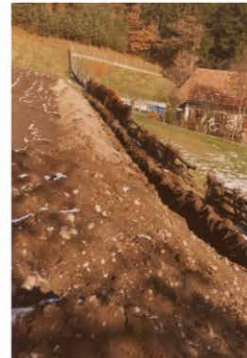
Mit dem Bau der Verbindungsleitung zur Langgasse im Jahr 1978 wurde auch der westliche Teil des Dorfes mit Stollenwasser versorgt. Die Ladinsleitung wurde vom Netz genommen. (Foto: Chronos)
