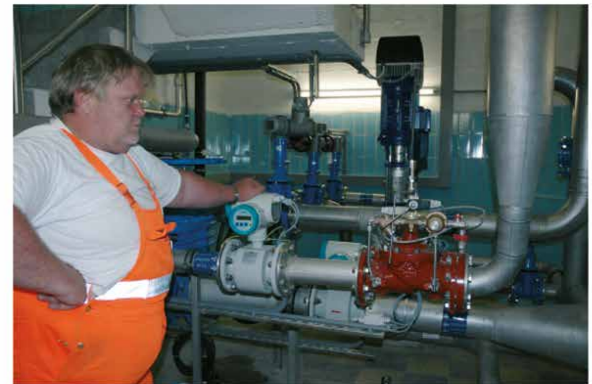
Im Untergeschoss des Hochbehälters befindet sich das Herz der Anlage mit den Pumpen. Hier „regiert“ Alfons Lechner über das zunehmend komplexere Wasserversorgungssystem unserer Gemeinde. (Foto: Chronos)
